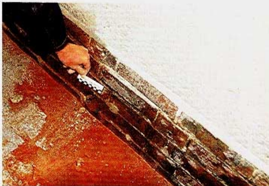
Abb. 2: Inaugenschelnnahme: Der notwendige Bohrlochabstand am Objekt ist nicht immer richtig eingehalten
