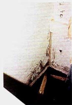
Abb. 3: Ortsbegehung: Die derartigen ersichtlichen hohen Feuchtwerte wurden gar nicht in den Messprotokollen ausgewiesen..
